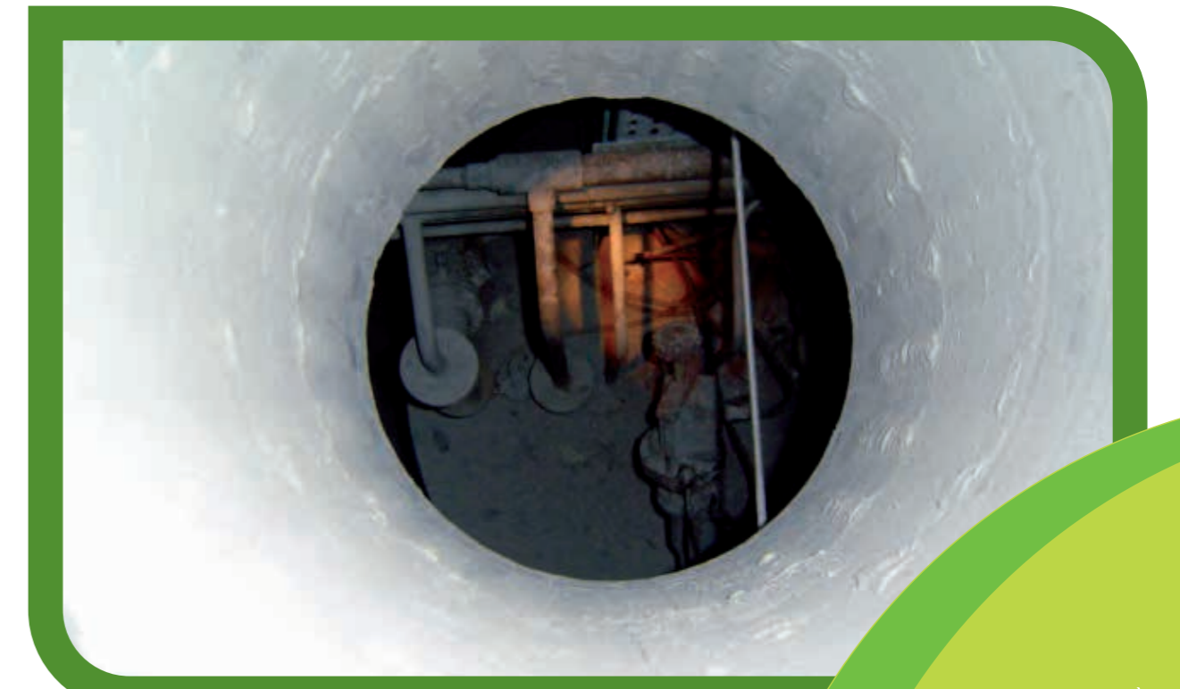
Point d'entrée de la caméra dans la salle des cuves.
