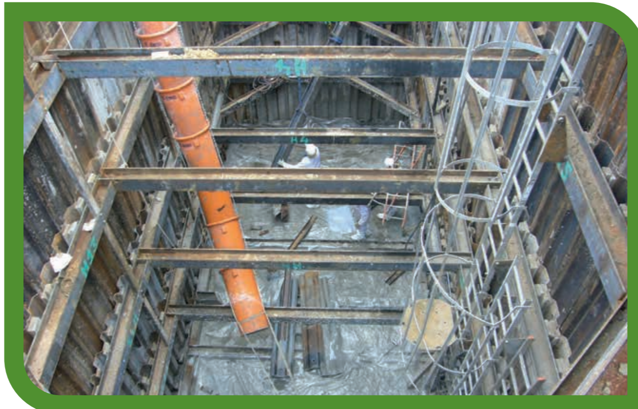
Atteinte de l'objectif radiologique : préparation du remblaiement avec du remblai liquide, contrôle des matériaux de blindage à la remontée.
