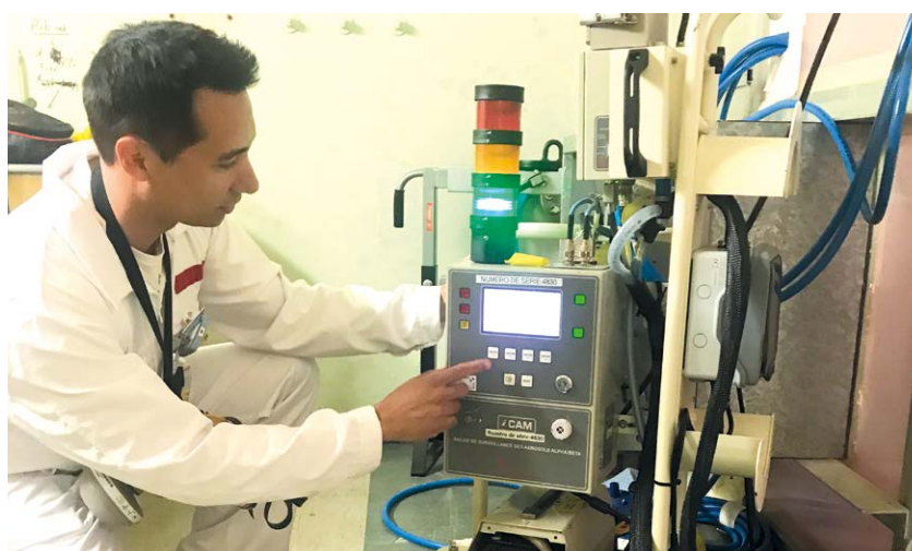
Chaque local d'une INB est équipé d'une balise de contrôle de radio activité.
