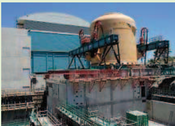
Fig. 8. Le chantier du RES, avec la mise en place de l'enceinte de confinement métallique.
