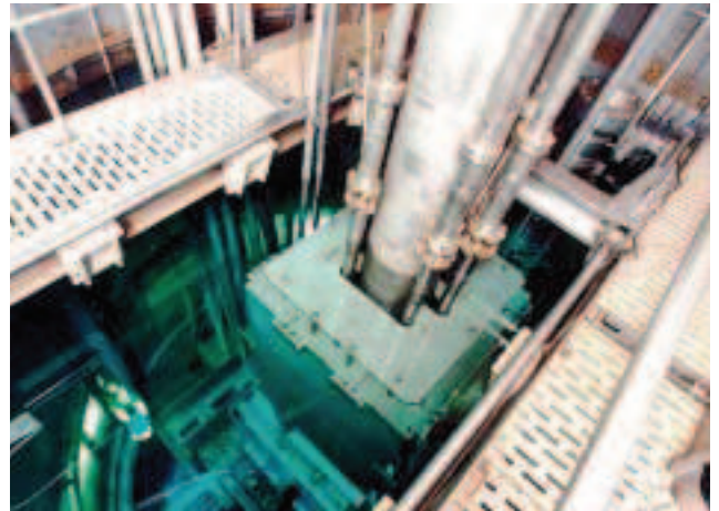
Fig. 115. Réacteur CABRI : vue de dessus du cœur dans la piscine et de la boucle d'essai qui le traverse verticalement.
