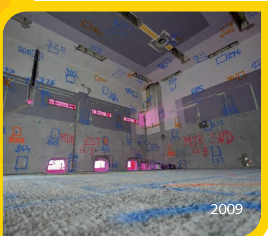
2009 Fin des travaux de démantèlement au LAMA (laboratoire d'analyse de matériaux actifs).
